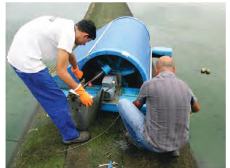
Aeradores da Lagoa da Estação de Tratamento de Esgoto passam por manutenção
