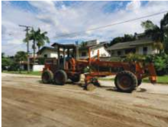
Manutenção dos módulos: limpeza de canaletas, caixas e galerias de drenagem e nivelamento das vias públicas.
