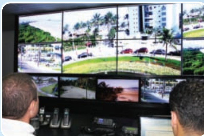
Central de controle do Sistema de Videomonitoramento
