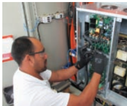
Manutenção preventiva nos painéis de comandos elétricos da ETA
