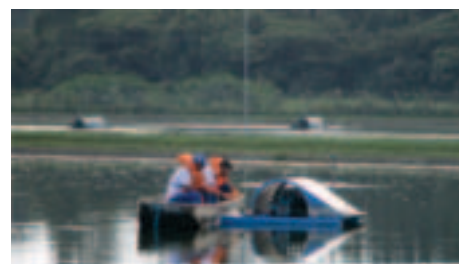
Substituição de flutuantes aeradores em lagoa da Estação de Tratamento de Esgoto
