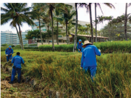
Manutenção no capim Vetiver (obra de restauração da parte superior da praia)
