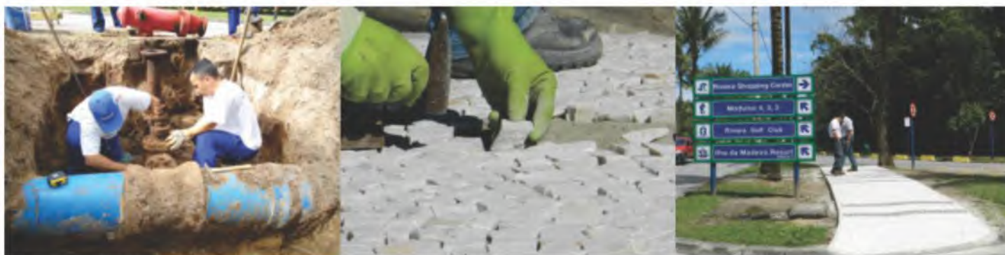
Realocação de hidrante na Av. da Orla para construção de calçada nas proximidades do Riviera Shopping
