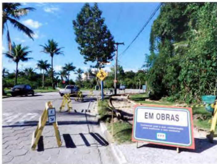
Reforma e construção de 230 metros lineares de novas calçadas na Av. da Riviera exigiu serviços na rede de água e esgoto, e o remanejamento de hidrante para uso pelos bombeiros
