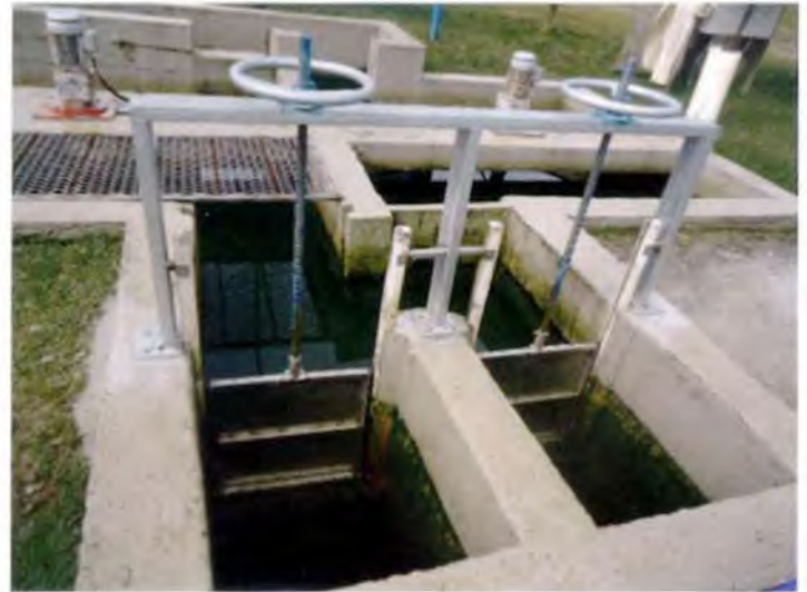
Substituição das comportas da entrada do removedor de algas da Estação de Tratamento de Esgoto (ETE)
