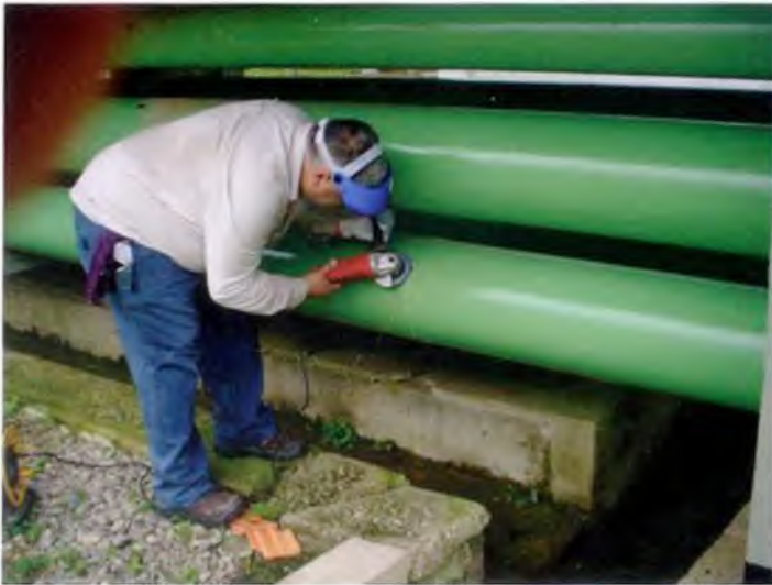
Inspeção da espessura das tubulações que alimentam o reservatório elevado da ETA, por empresa de engenharia especializada
