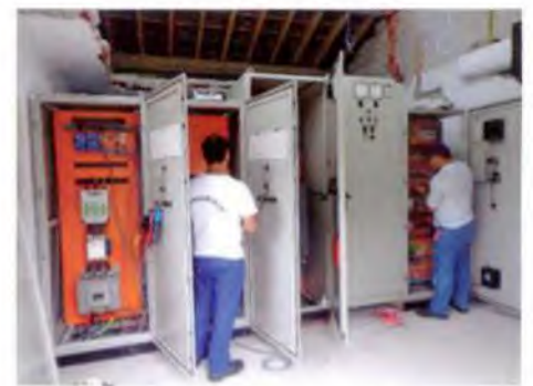
Conclusão da reforma da sala de painéis da Estação Elevatória de Esgoto
