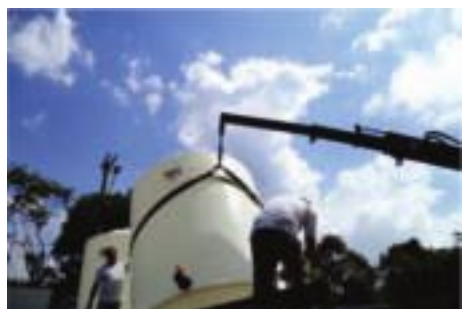
Substituição de tanques de fibra de vidro de hipoclorito de sódio da ETA por tanques de prolipropileno
