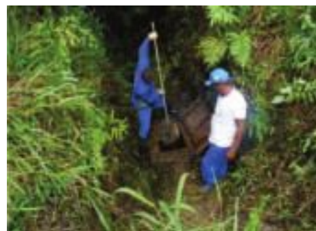
Manutenção de caixas de drenagens, canaletas, passagens de pedestres e vias públicas
